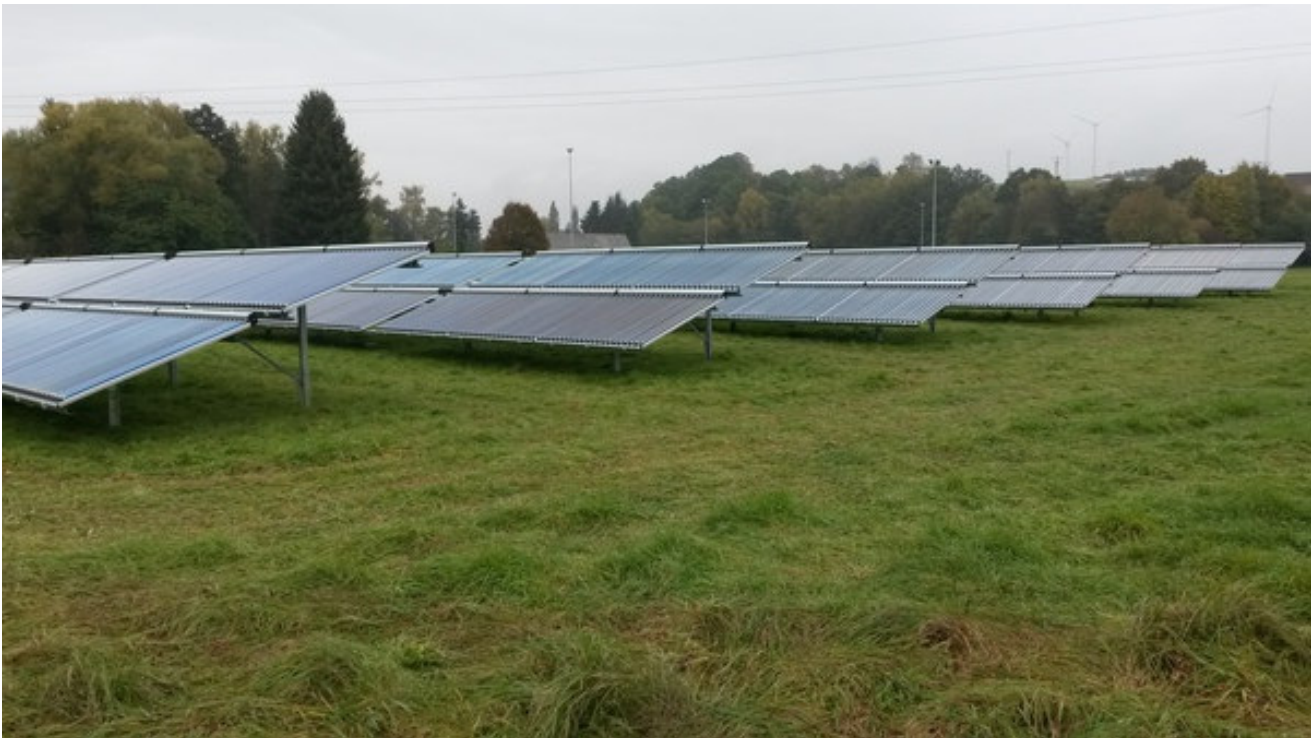
Vakuumröhrenkollektoren nutzen Sonnenenergie zur Wärmeerzeugung. Quelle: Verbandsgemeindewerke Simmern
