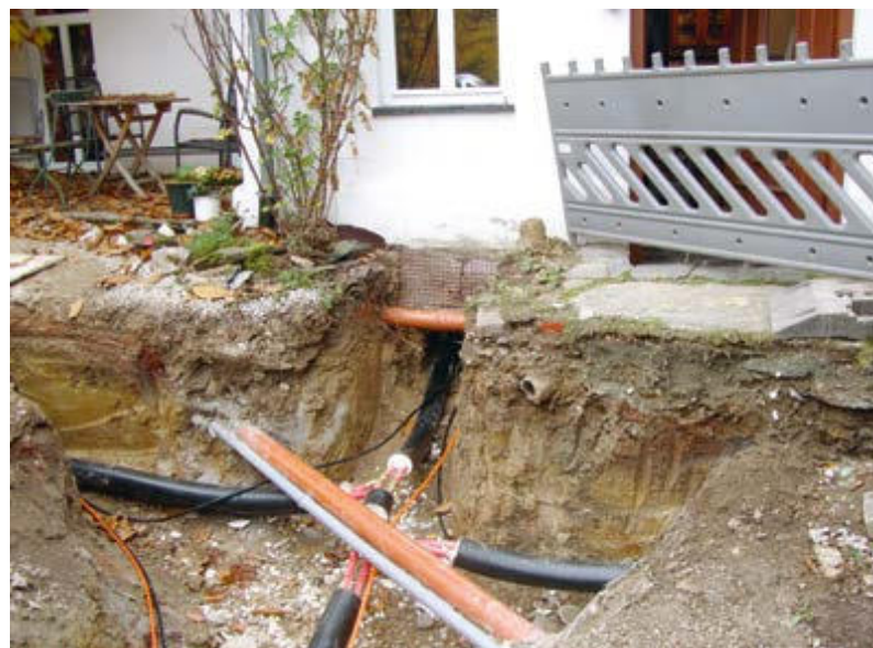
Drei Hausanschlüsse auf engstem Raum für Nahwärme und Glasfaser
